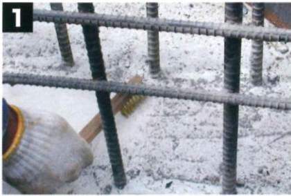
① 表面に付着しているゴミ、レイタンス等をワイヤーブラシで取り除いてください。
